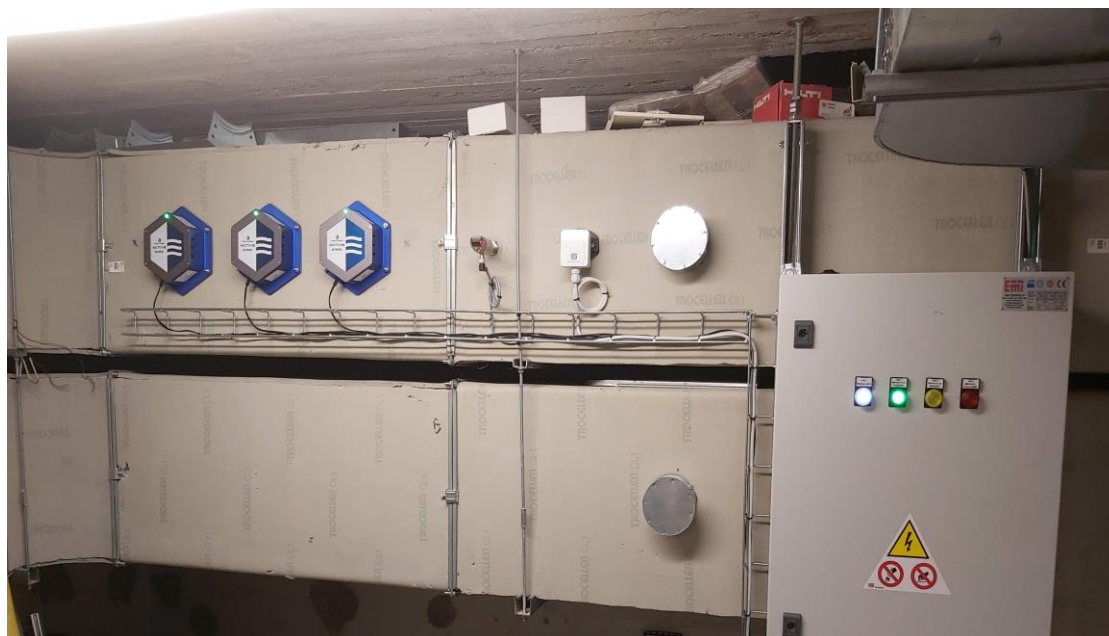
Figura 2 Sistema iUTA installato sull'UTA I del ristorante VIVA
